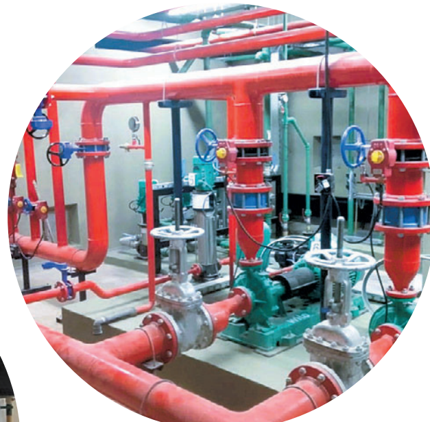
Instalaciones contra Incendio
