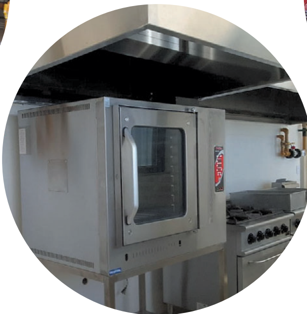
Instalaciones de Gas
