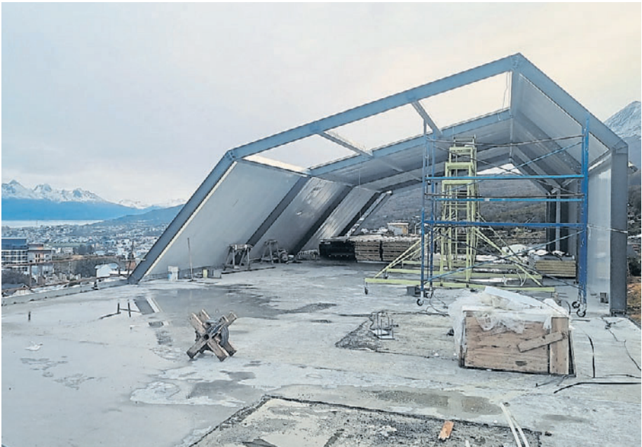
CUBIERTA. La piel posee un novedoso sistema de paneles de chapa y poliuretano.
